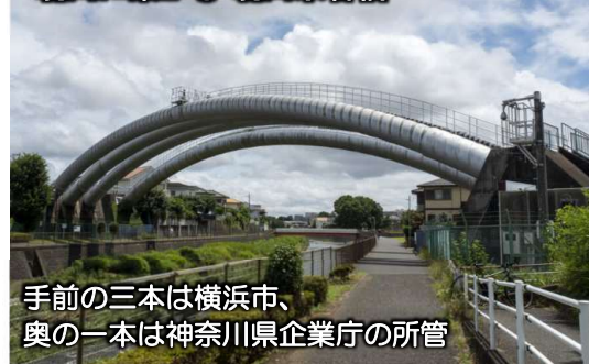
境川に架かる"境川水管橋"
